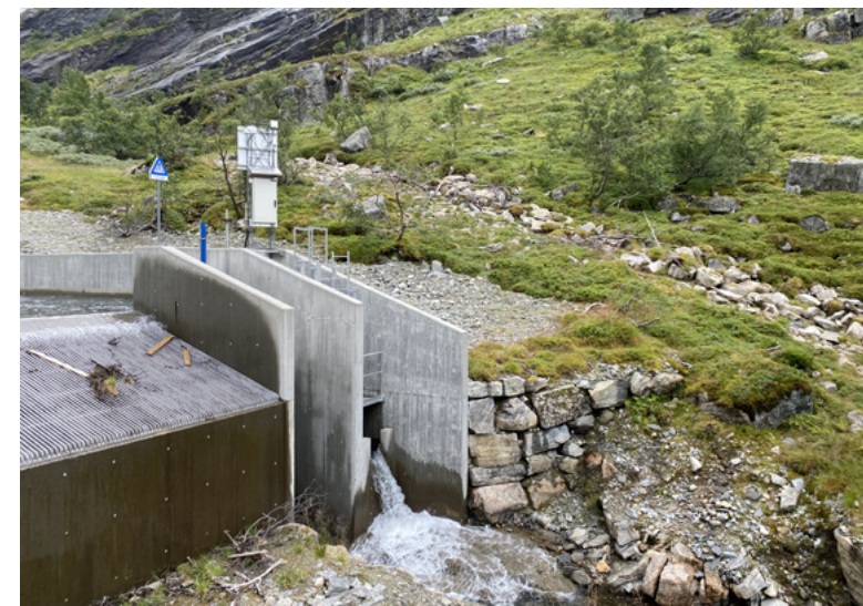
Minstevassføringslepp frå bekkeinntak i Randalen, Østerbø kraftverk
